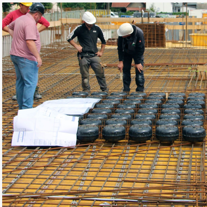
Riunione di costruzione: il piano di installazione dettagliati viene attuato con precisione. Fonte: Aller-Weser-Klinik gGmbH.
